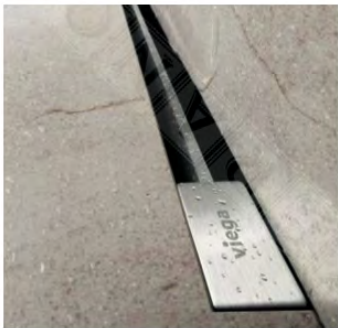
Drainage channels Canais de drenagem (instalados no chão).
